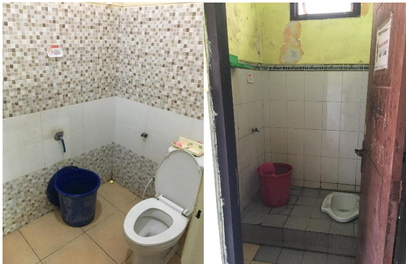
Gambar 1. Kondisi toilet SDN Kali kedinding V/579B
