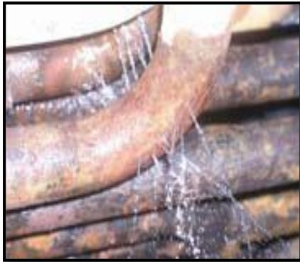
Gambar 3. Bocor pada pipa low pressure evaporator
