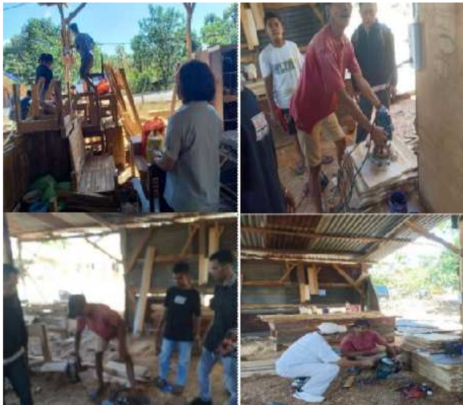
Gambar 5. Uji Coba Semua Peralatan yang Menggunakan Sumber Energi Listrik
