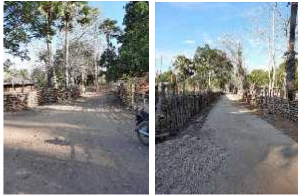
Gambar 1. Kondisi Jalan Dusun yang Belum Beraspal
