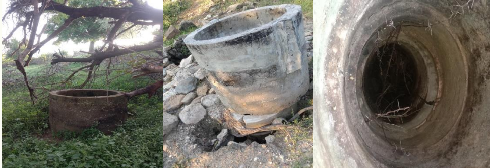
Gambar 1 Sumur yang tidak di rawat
