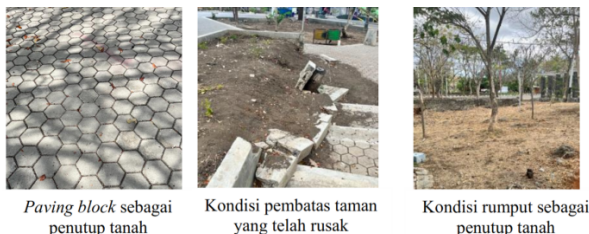
Gambar 5. Material penutup tanah dan kondisinya
