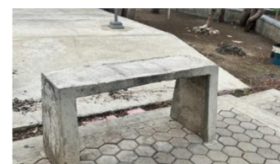
Kondisi bangku taman yang rusak
