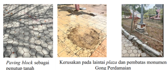
Gambar 15. Material penutup tanah dan pembatas monumen gong yang telah rusak
