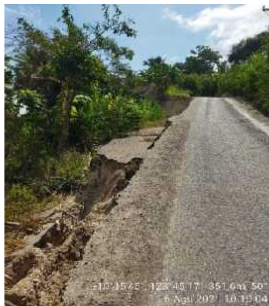
Gambar 1. Longsor di Pinggiran Jalan Umum
